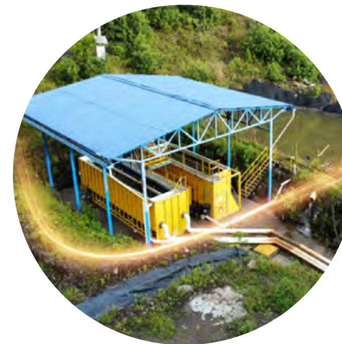
Planta de tratamiento de agua no doméstica 40 (Ubalá, Cundinamarca). Fuente: PazdelRío.
